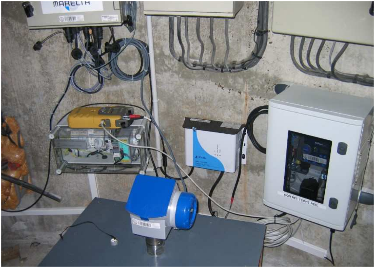
Fig.7 : Vue du récepteur GB-1000 installé dans le local du MCN (le marégraphe radar est en premier plan)
